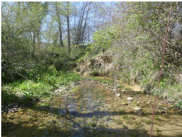
Le ruisseau de Sénesse - érosion de berge («Plane de Réguinet»)
