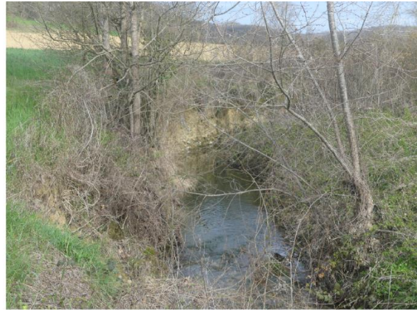
Le ruisseau de Sénesse - érosion de berge («La Plaine»)
